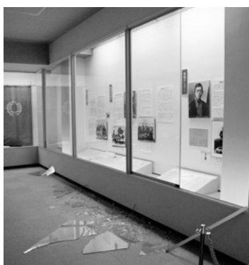
→本館の破損状況
