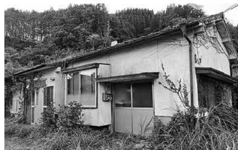
老朽化した空き家(例)→
