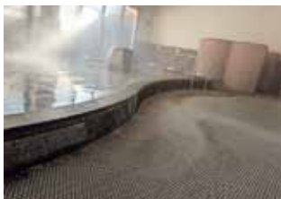
↑ 漏水箇所がある浴槽
