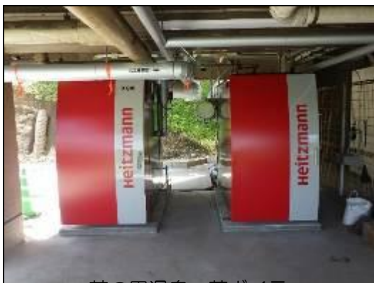
荻の里温泉・薪ボイラー
