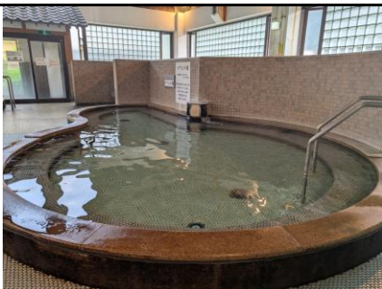
漏水がある浴槽①
