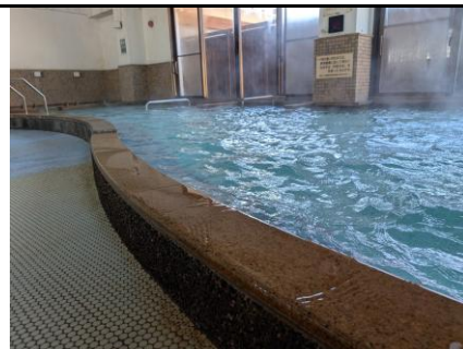
漏水がある浴槽②
