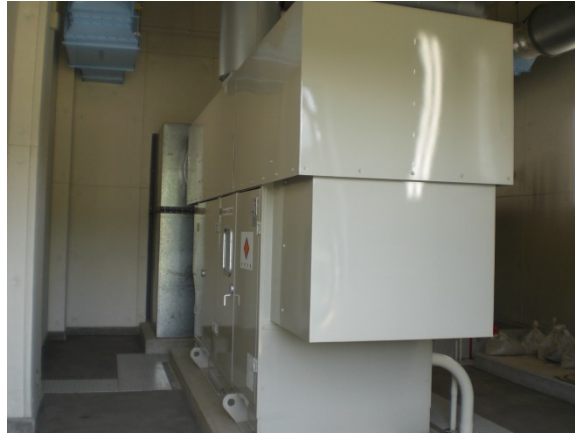
写真 5.3.7 自家用発電設備（参考）
