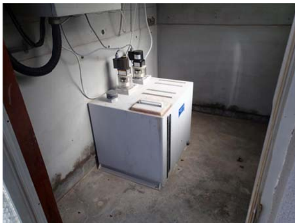
写真 5.1.1 第 2 水源次亜設備
