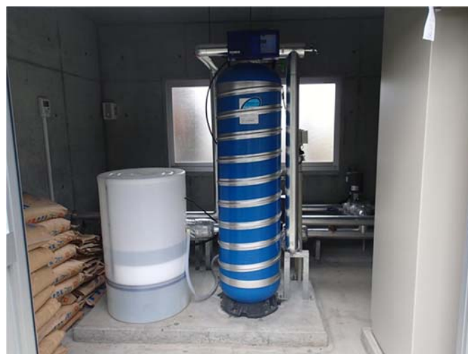
写真 2.3.1 戸上浄水場硝酸態窒素除去設備（イオン交換樹脂施設）
