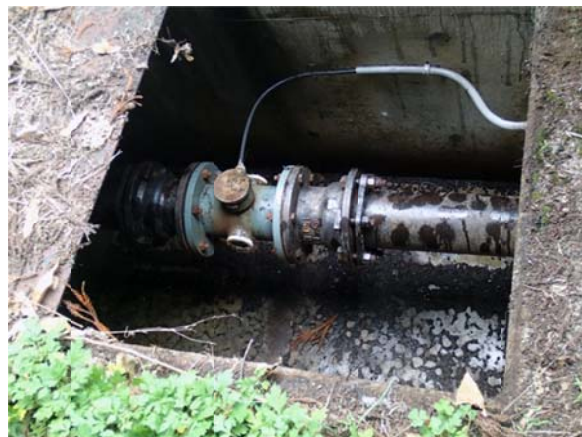
写真 5.1.2 第 5 配水池計装設備(配水流量計)
