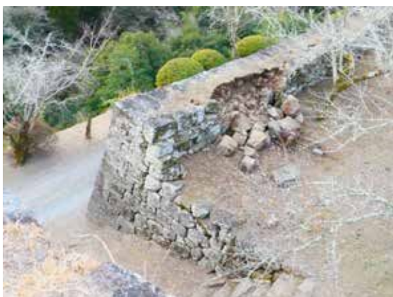
岡城跡石垣崩落状況（日向灘地震）
