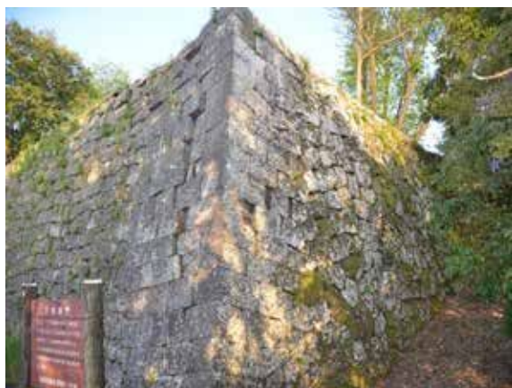
岡城跡下原門の石垣孕み・ずれ状況（熊本地震）
