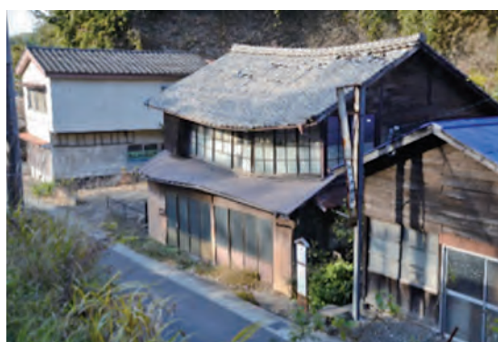
老朽化が進む住宅
