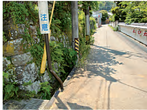
色落ち・老朽化した道路舗装
