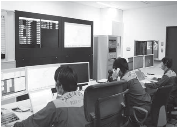
▲新庁舎に整備された高機能消防指令装置
